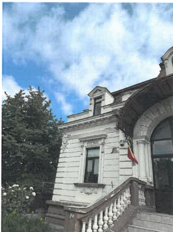
Fig. 1 Degradari tencuieli exterioare
