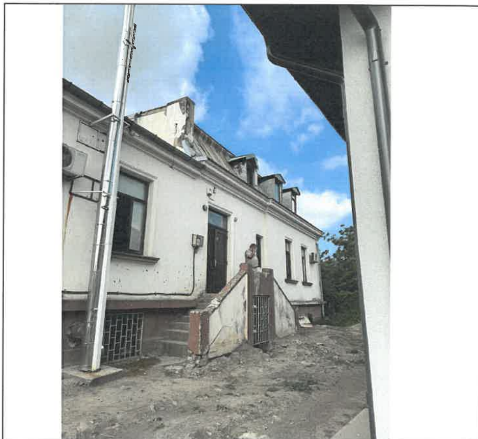
Fig. 3 – Fisuri majore in scari exterioare. Timpan zidarie degradat. Tabla acoperis degradata
