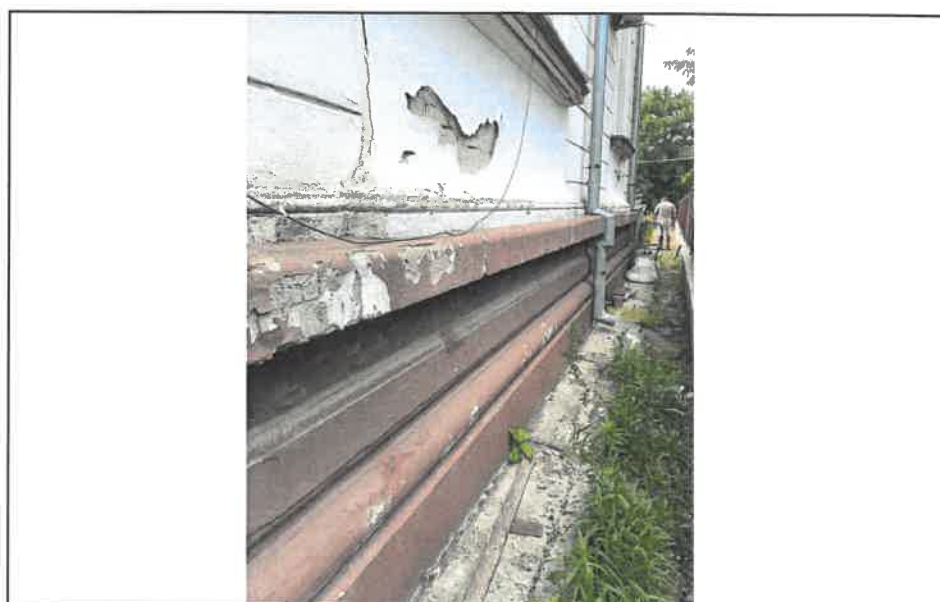
Fig. 4 – Degradari soclu si tencuiala
